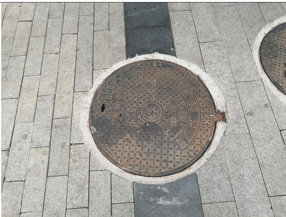
图 5-2 项目 A 区公建部分污水管网井盖现状
